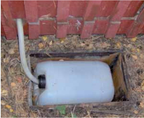
Recipiente de armazenagem da urina no exterior, por enterrar.
