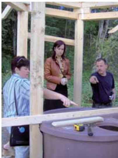
Construção de casa de banho com um modelo de saneamento a seco rotativo de manutenção pelo exterior.
