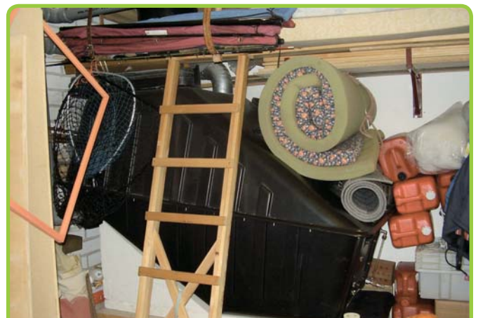
Säiliö on sijoitettu lämmitetyn askarteluhuoneen nurkkaan, jota käytetään myös ylimääräisen tavaran varastointiin.
