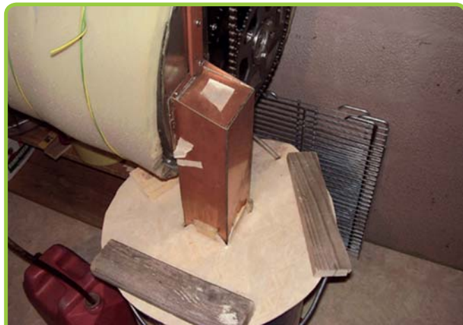
Säiliön päässä on ämpäri, johon kompostoitunut käymäläjäte tippuu.
