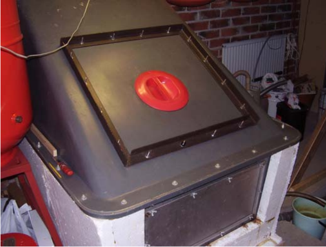
Kuva 3 Käymälän säiliö. Käymälä tyhjenetään säiliön päälle tehdystä luukusta
