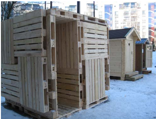
Oulun yliopiston kurssin kansainväliset arkkitehtipiskelijät rakensivat pihalle huussin, joka on tehty puisista kuormalavoista. Huussi sopii erityisesti kehitysmaihin, koska lavoja tulee niihin kansainvälisten avustuskuljetusten mukana.
